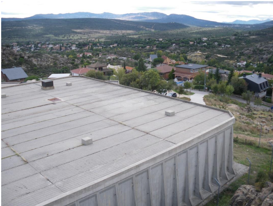
Foto 9.-Depósitos de agua (c. del Clavel).
