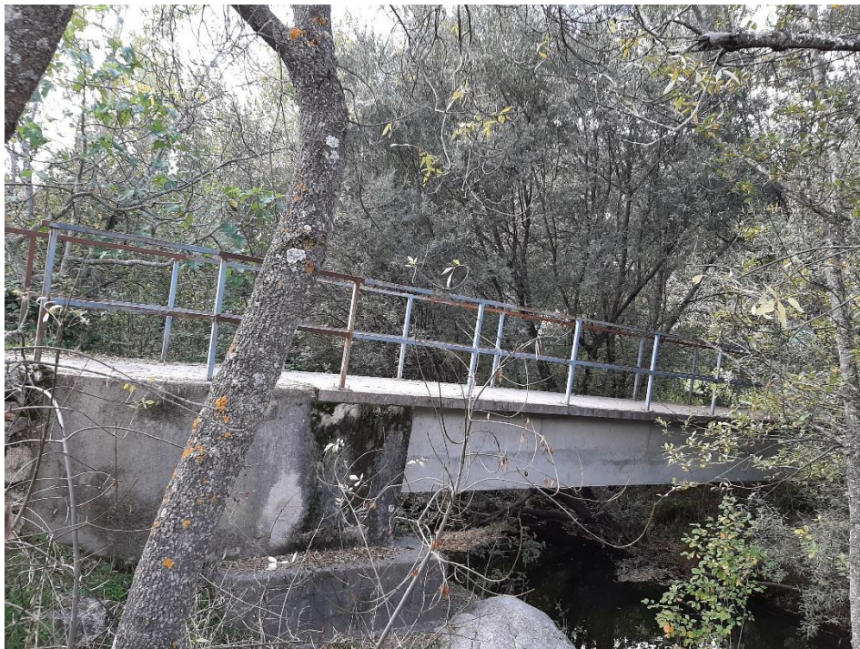
Foto 10.- Paso de conducción sobre el río Manzanares en avda. de la Pedriza.
